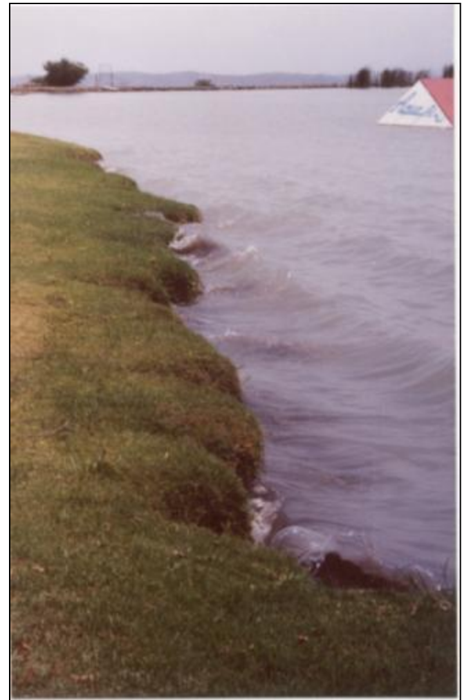
Erosion verursacht durch Wellen
